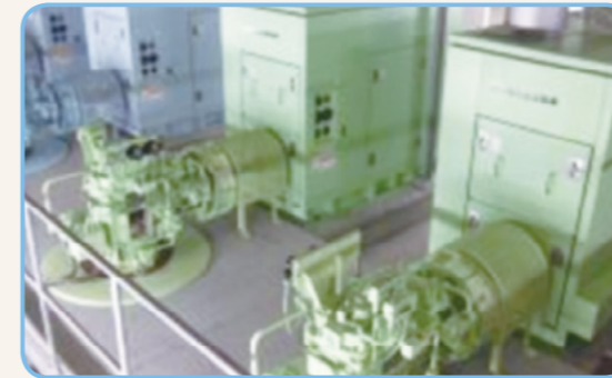
市内の雨水ポンプ場
